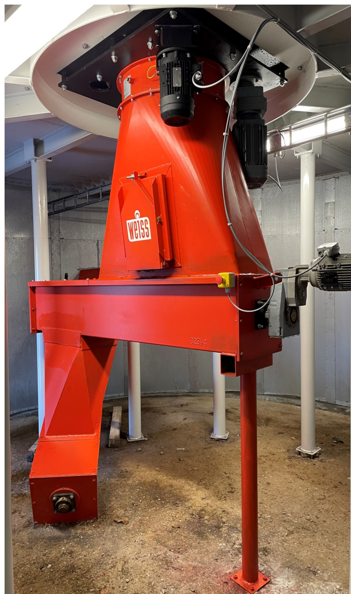
På billedet ses Weiss NFU i bunden af siloen med transportsnegle ind til kedelanlægget.
