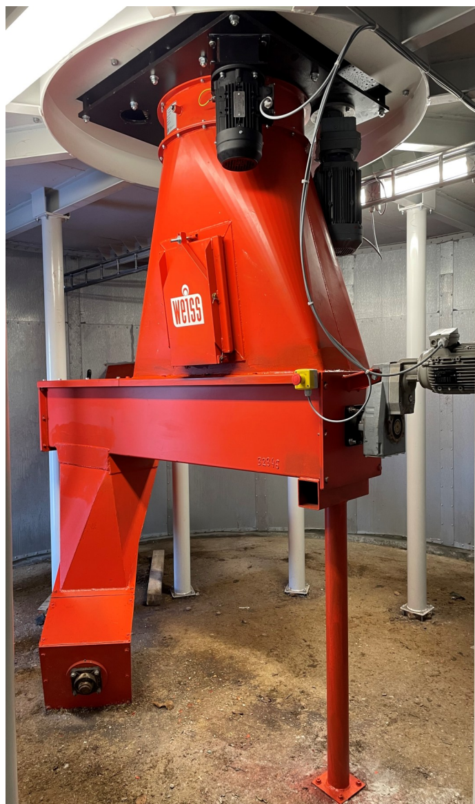
På bilden syns Weiss NFU i botten av silon med transportskruvar in till pannanläggningen.
